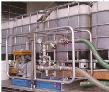
専用ポンプを積載し納入します 払い出し時間はローリーとほぼ同等です
